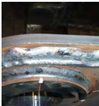
Exemplu de pozitionare incorecta a sarmei
