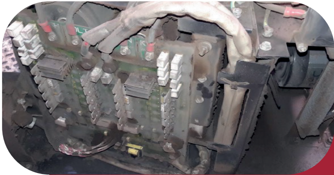
Máquina antes del mantenimiento.
