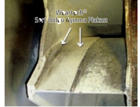
Weartech® ile Korunmuş Fan Kanadı — 12 Ay Çalıştıktan Sonra —
